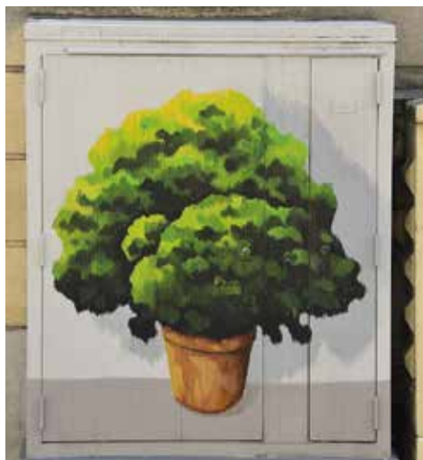
Trompe l'oeil sur un coffret d'alimentation électrique
