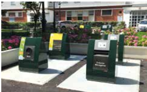
Conteneur enterré pour les déchets ménagers
