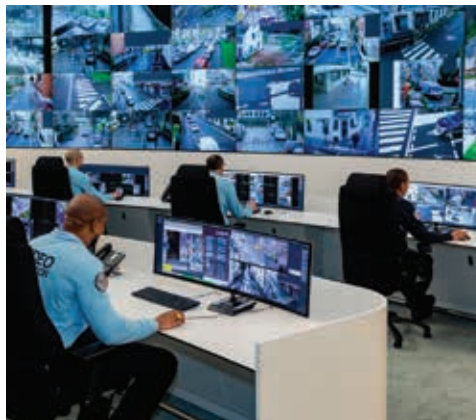
Centre de Commandement et de Supervision Urbain
