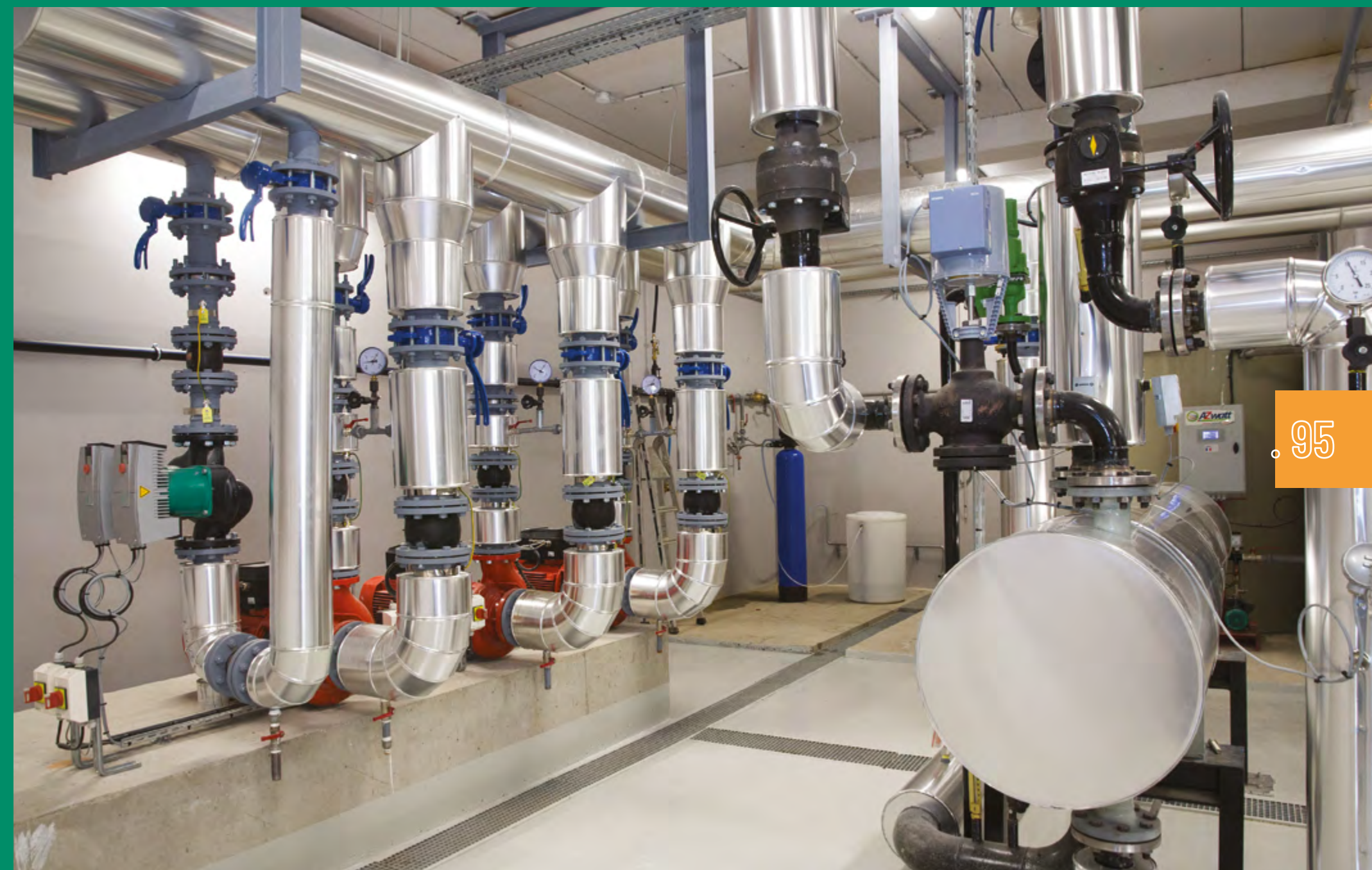
Sous-station de chauffage de l'ÉcoQuartier des Bergères
