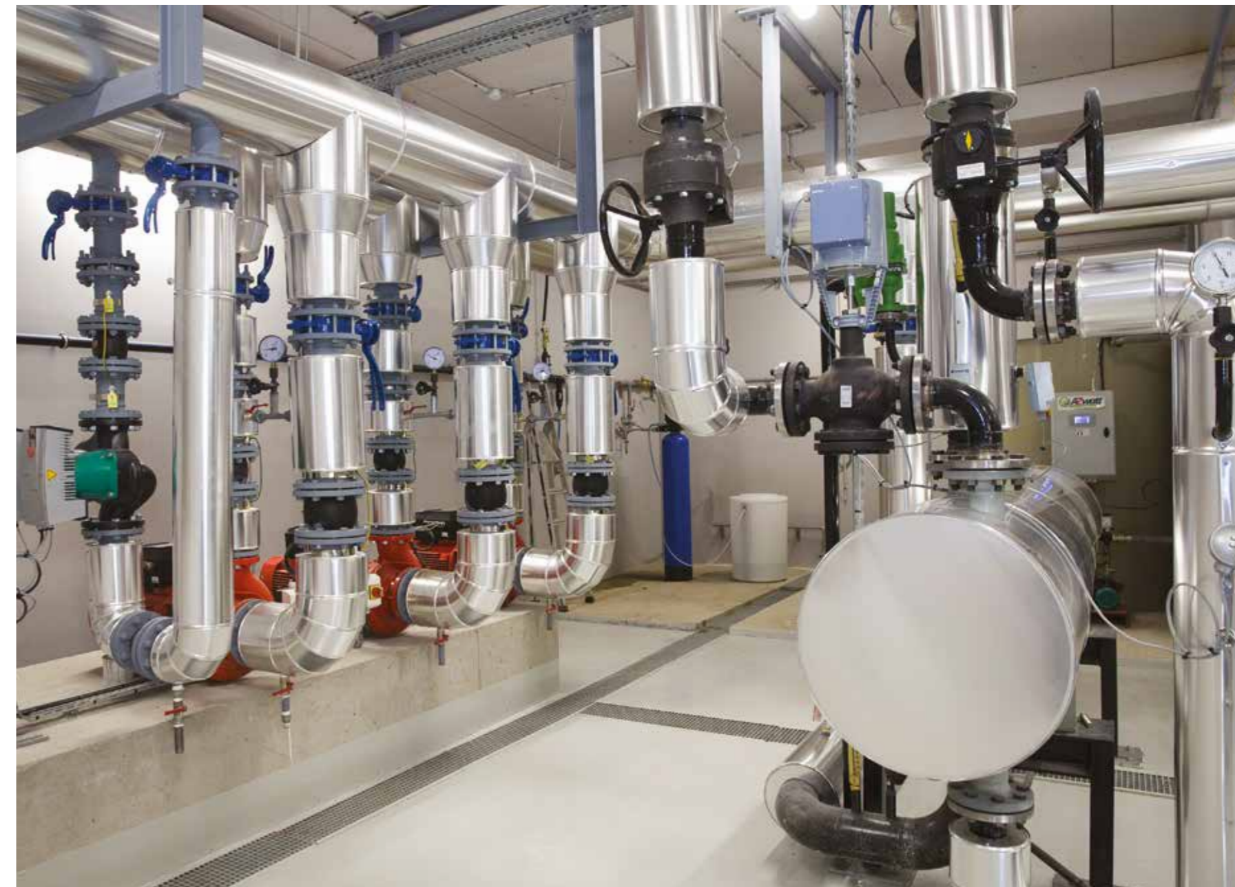
Station de chauffage de l'ÉcoQuartier des Bergères
