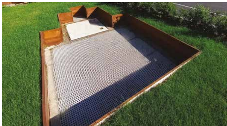
Cuve de récupération des eaux pluviales sur l'Île de Puteaux
