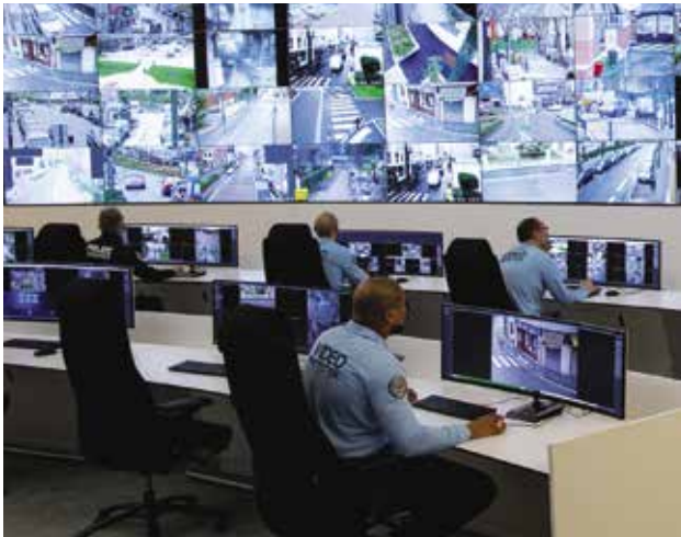
Le CCSU (Centre de Commandement et de Supervision Urbain)
