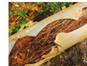
Racines d'arbres s'infiltrant dans un réseau
