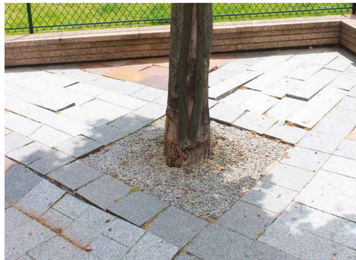
Destruction d'un revêtement par des racines
