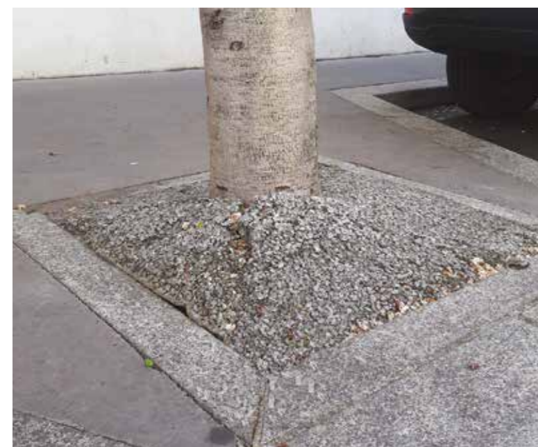
Pied d'arbre imperméabilisé affectant son développement
