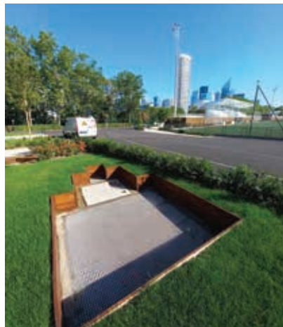
Cuve de récupération des eaux pluviales sur l'île de Puteaux
